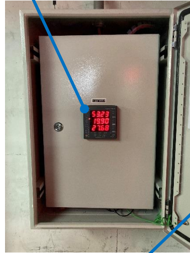
Concentrador de datos: Schneider-electric ComX510
